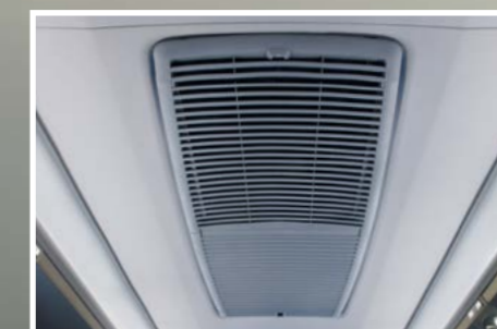
Rejilla de aire acondicionado integrada al techo con mantenimiento facilitado
